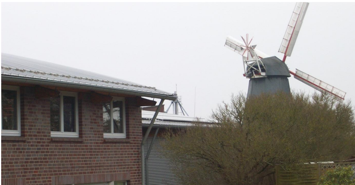
Abbildung 1: Photovoltaikanlage der Samtgemeinde Bardowick, Feuerwehrgerätehaus, südliches Dach (Foto: NLG)
